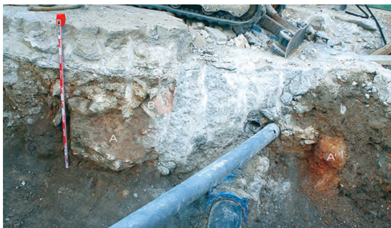
Fig. 22: Pervivencia, meramente testimonial, del canal histórico de la calle Río, en su sector colindante con la Plaza de Andalucía. Los daños producidos no corresponden a las obras realizadas en 2022-2023, sino a otras anteriores (siglo XX). Se reconocen los dos laterales de dicho canal (A-A') y el arranque de la bóveda de ladrillo que lo cubría (B). No se descarta, al amparo de las fuentes documentales, que se trate de un puentecillo dispuesto para salvar el cauce.
