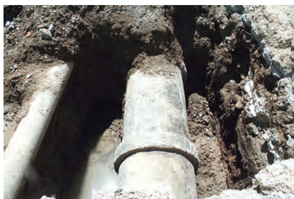
Fig. 6: Detalle de la tubería de hormigón armado instalada en 1927-1929 y que ha sido desmantelada en 2022-2023. Identificada en el sondeo de 2000 como UE 8. Fotografía de 2022.
