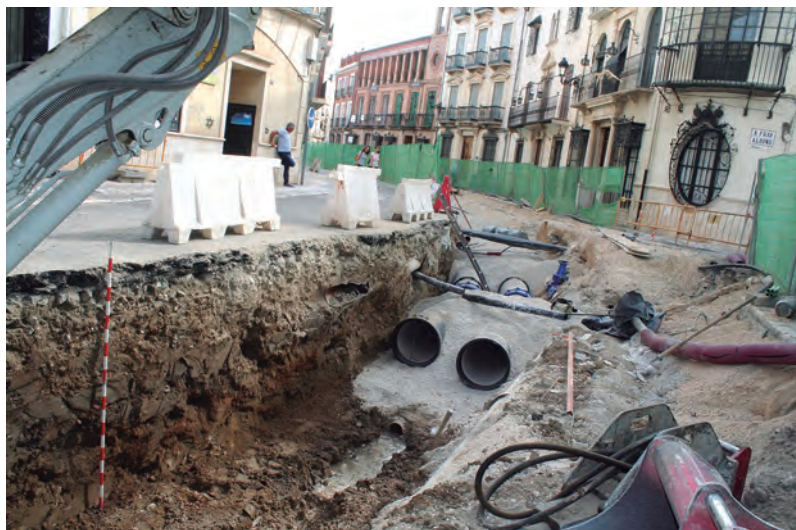
Fig. 13: Panorámica de la intersección de las calles Río y Fray Albino durante las obras y que muestra la entidad de las remociones de tierras practicadas. La estratigrafía natural o arqueológica del viario ha quedado agotada, tras la apertura de otras zanjas posteriores, hasta la cota relativa de -200 cm..
